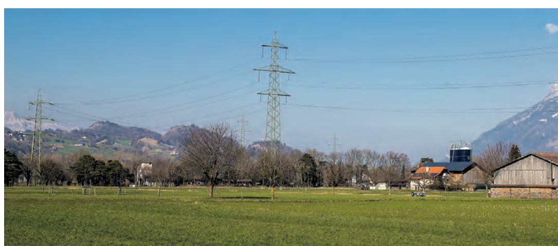
Die Hochspannungsleitung Balzers verrichtet ihren Dienst nur noch drei Jahre. Bild: Daniel Schwendener
